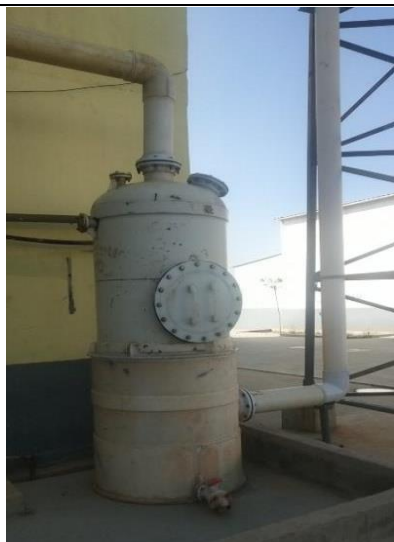
1.光稳定剂车间废气处理设施
