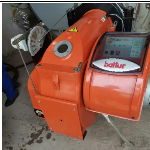
5. 锅炉低氮燃烧器
